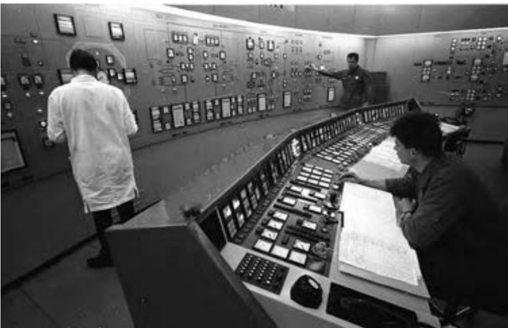
Der Kontrollraum des Versuchsatomkraftwerks Lucens, 1968. Foto: Josef Schmid
